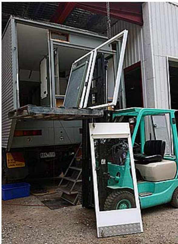
La fenêtre de derrière et la porte mordent la poussière.
